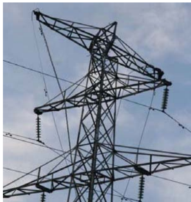
Figuur 2.5 Hoogspanningsmast in Haaksbergen met getordeerde toptraverse en gebroken bliksemraden
